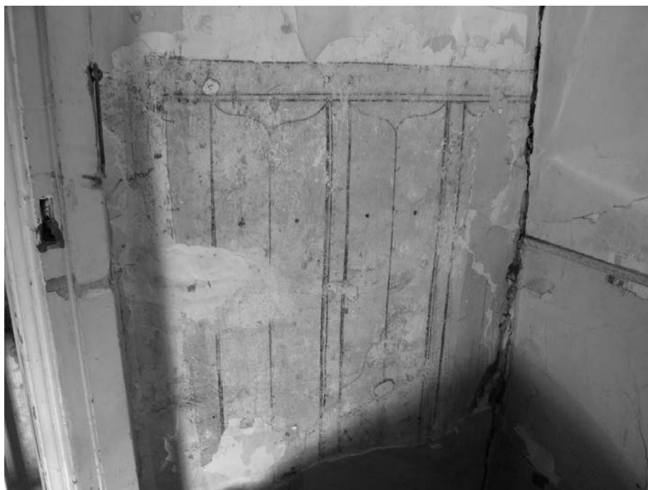
Het einde van de geschilderde lambrisering tegen de linkerzijmuur op de verdieping in het achterhuis. (foto BAM, Gemeente 's-Hertogenbosch)
